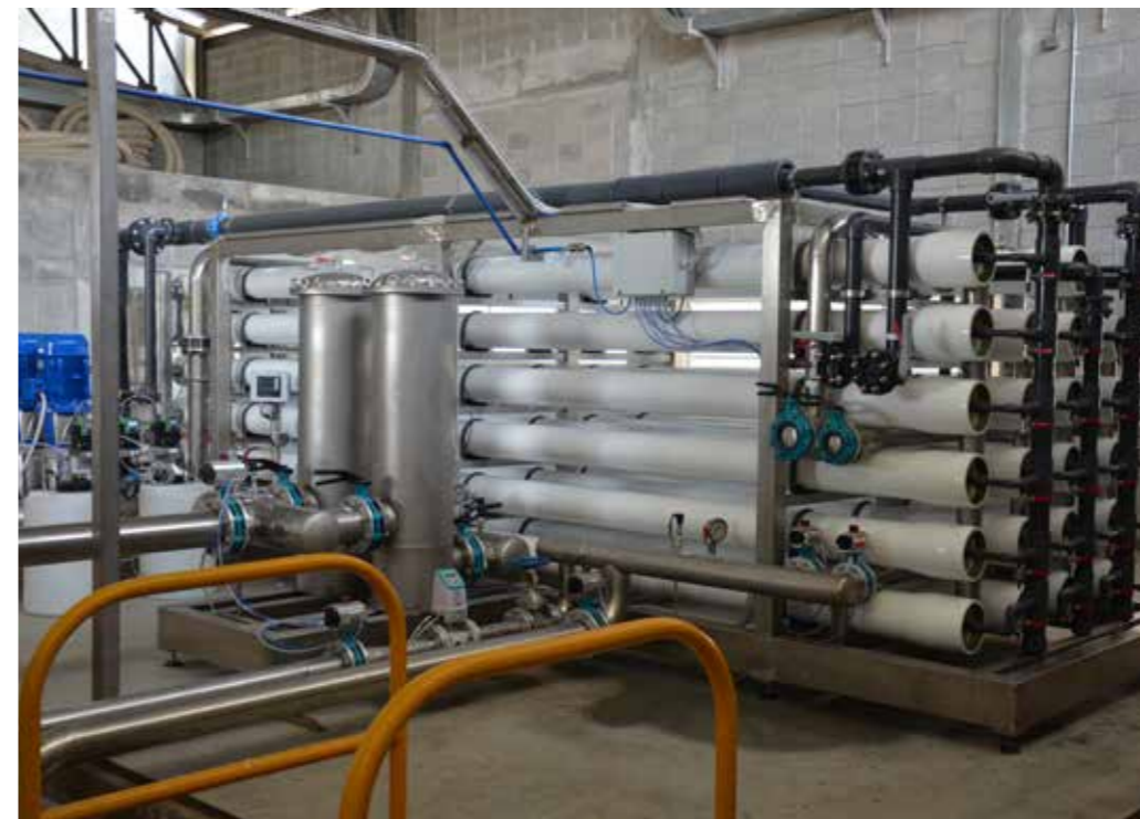
L'IMPIANTO A OSMOSI INVERSA
